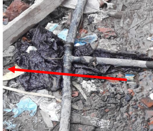
Foto 9. Conexión de agua no formal con pérdidas
